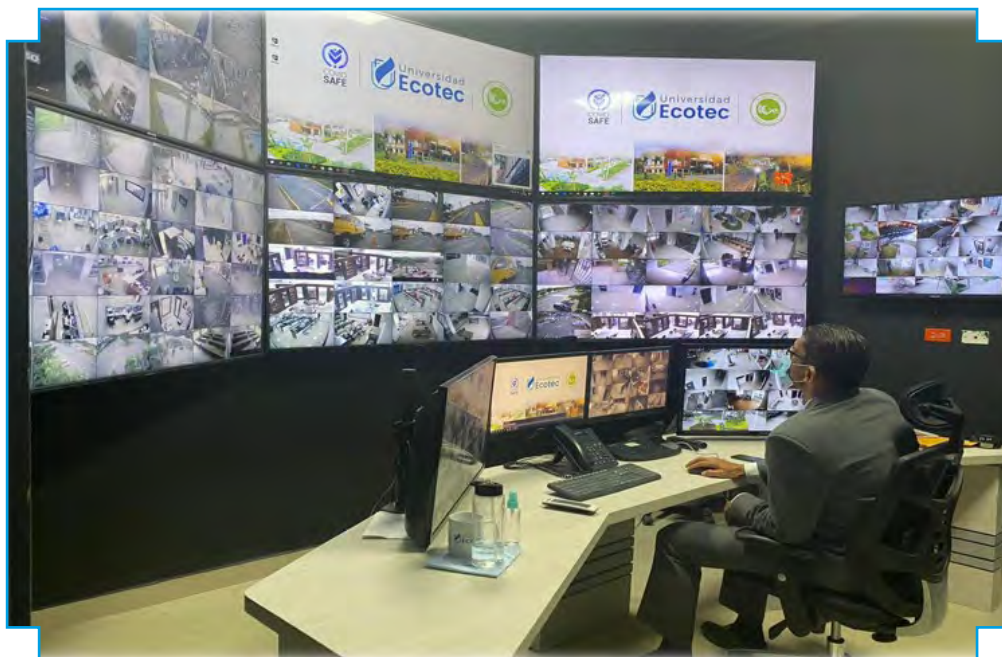
Sistema de vigilancia
